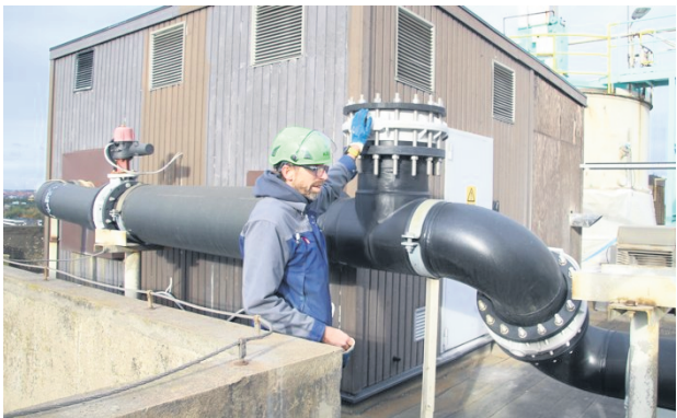
Dan Turesson visar hur allt är förberett för att koppla in Heat-pipe. När allt är klart kommer bolaget spara 40-50 procent av nuvarande vattenförbrukning och 20 procent av gasanvändningen.
