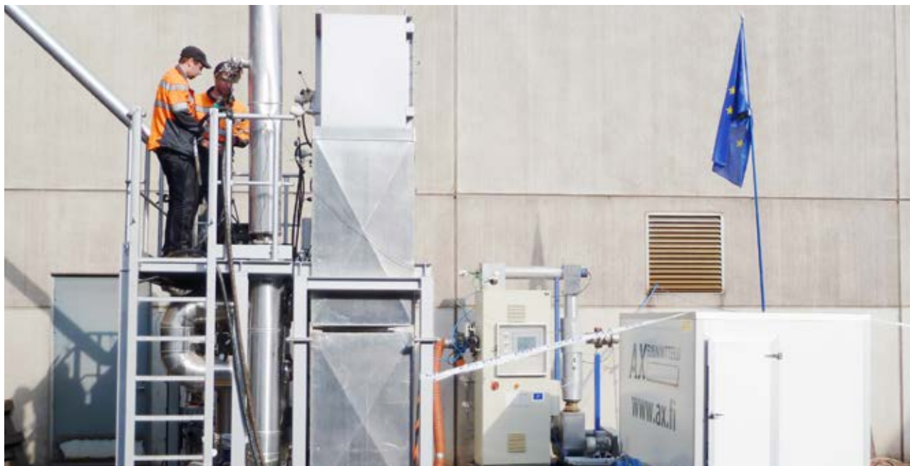
Kontroll pågår av den RTO-prototyp som användes i projektet. I RTO:n sker förbränning av de luktande ämnena.
